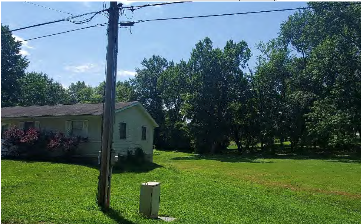
CASSCOMM PON Cabinet (Riverton)
